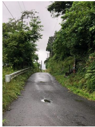
⑧道幅が狭い。アップダウンがあり，見通しも悪い。
