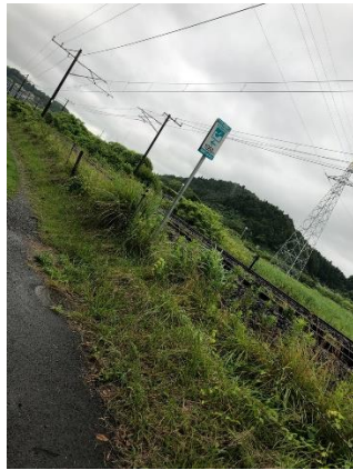
⑦線路内へ容易に進入できる状況になっている。
