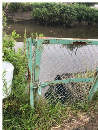
⑪田中川沿いのフェンス。ズレが見られる。
