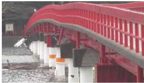
東日本大震災で破損した橋脚
